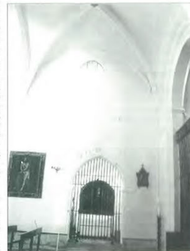
Vista general del paramento sobre el arco de entrada de la Capilla de Ntra. Sra. de Gracia.
